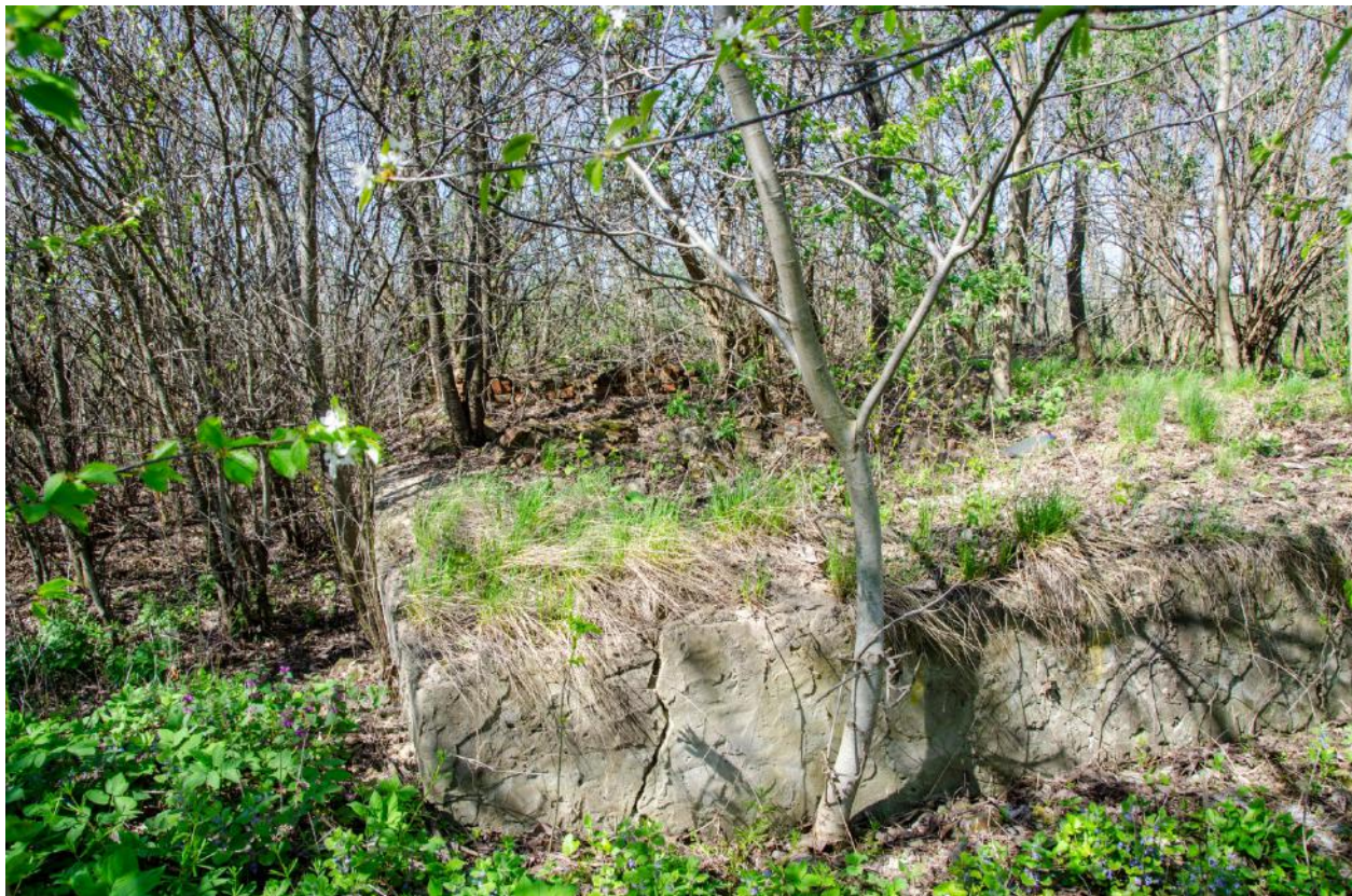
Недовершений фундамент – необлаштоване гніздо
